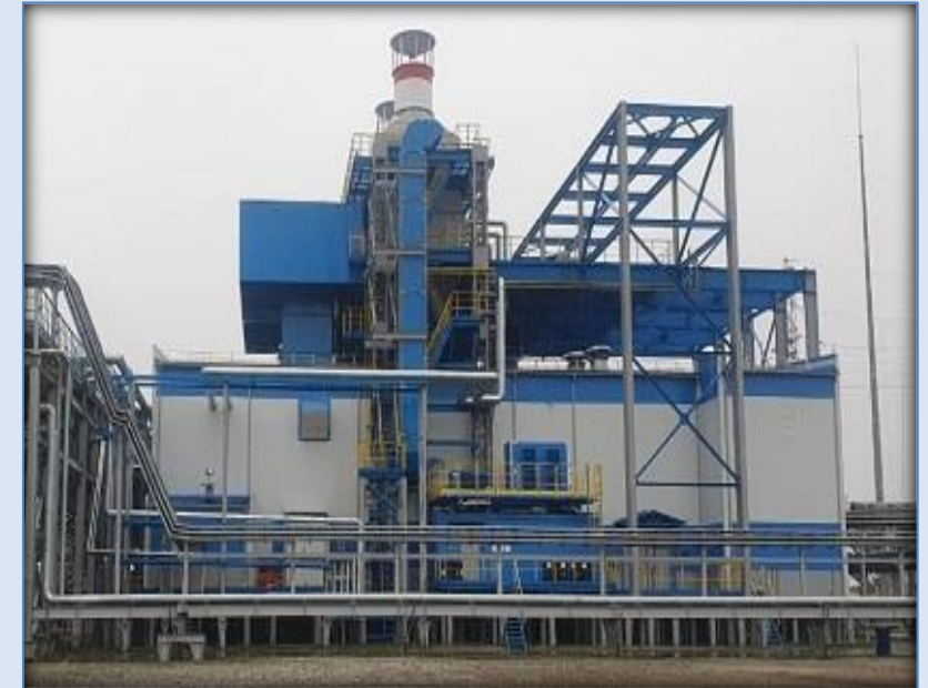
ГТЭА-12МВт в ООО «Газпром добыча Надым»
