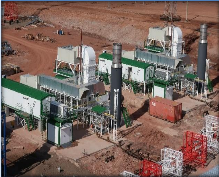
ГТЭА-6МВт для «Иркутской нефтяной компании»
