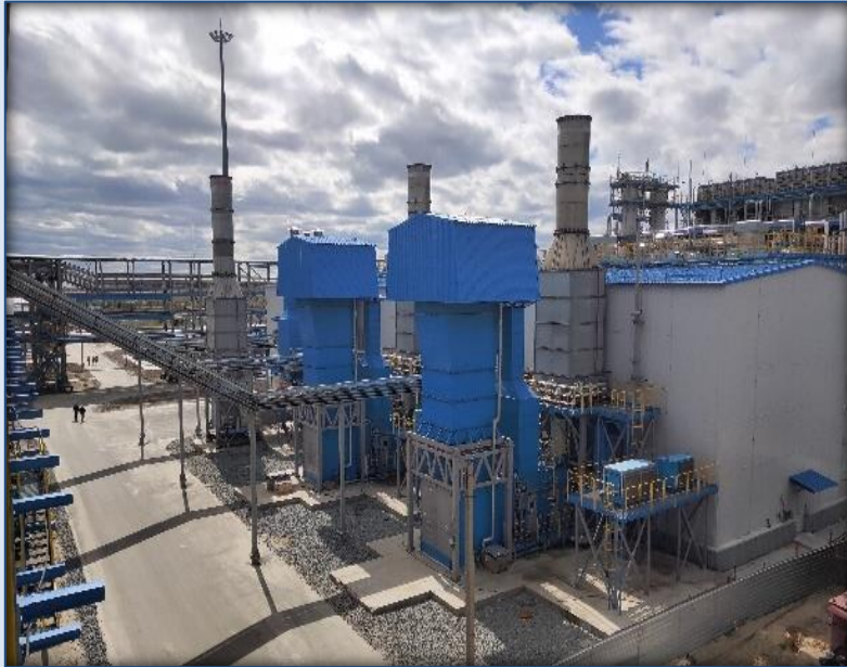
ГПА-6МВт и ГПА-10МВт в ООО «Газпром переработка»
