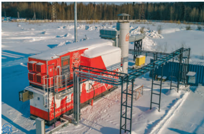
Рис. 7. ГТЭА-2000 «Иртыш» с приводом от газотурбинного двигателя мощностью 2 МВт ГТД АА-2000
